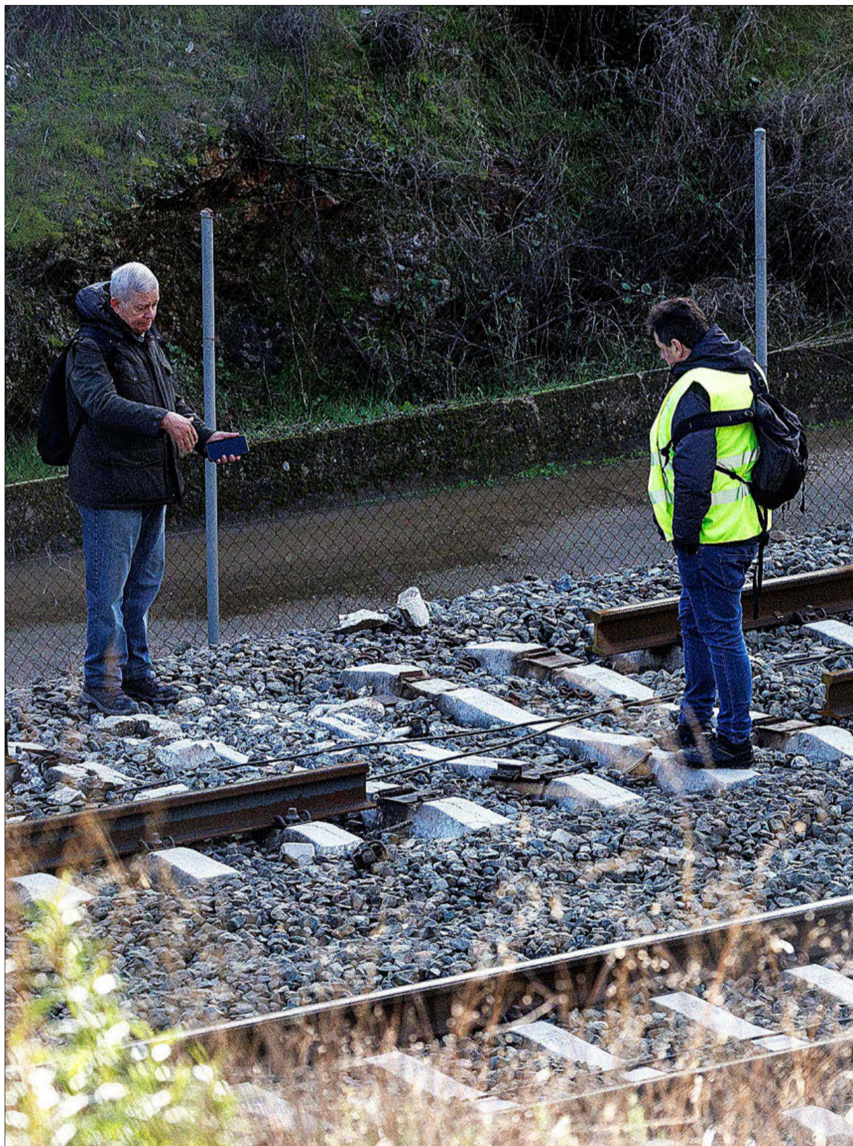
Especialistas examinan el tramo de la vía entre Madrid y Andalucía que se rompió en Adamuz. CARLOS GARCÍA POZO
