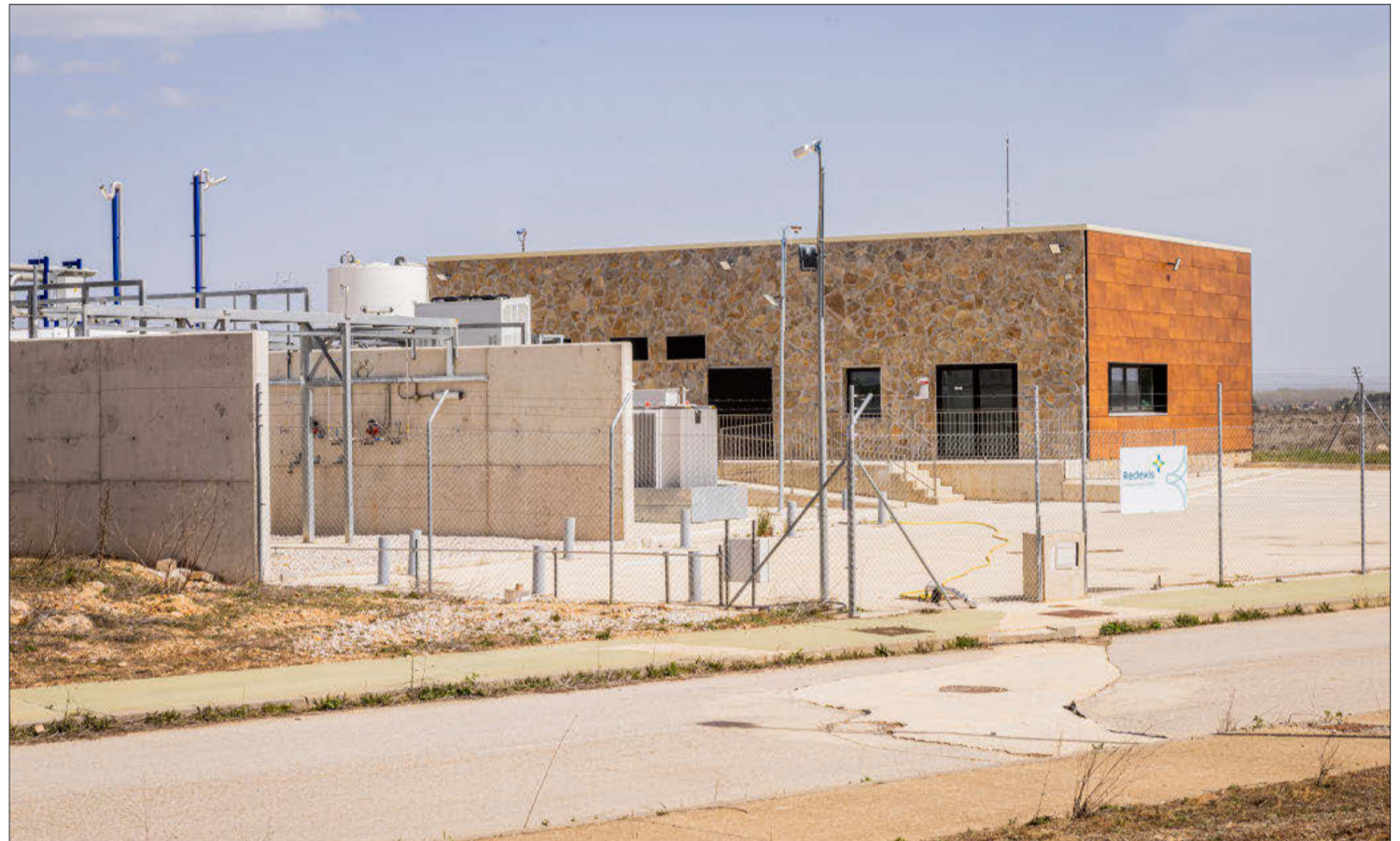
Instalaciones de la planta de hidrógeno verde del PEMA de Garray. MARIO TEJEDOR
